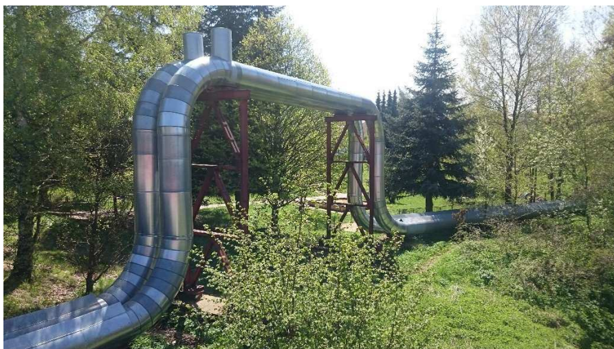
Obrázek 2 Venkovní rozvod horkovodu
