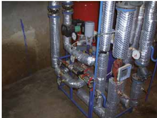
Objektová předávací stanice.
