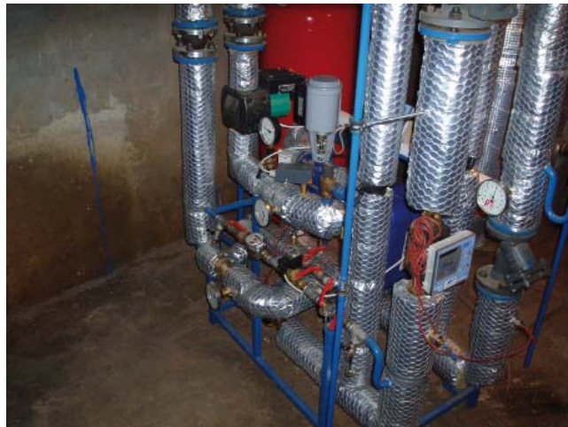
Objektová předávací stanice.
