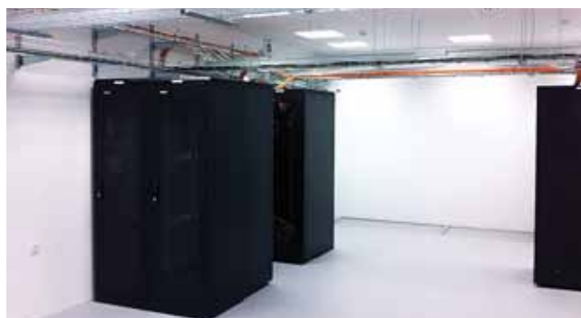
Prostory VS 23 po přestavbě (serverovna).
