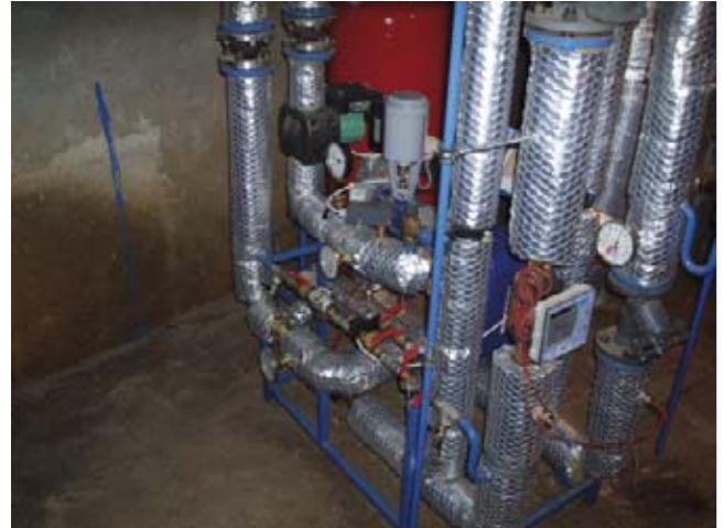
Objektová předávací stanice.
