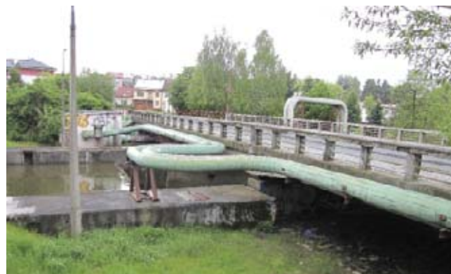
Původní izolace horkovodu.
